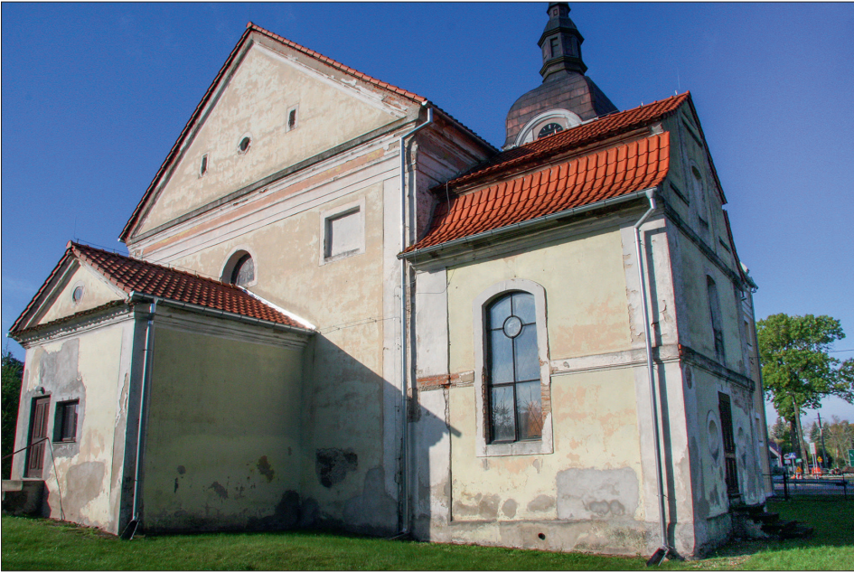
Fot. 2. Widok z tyłu kościoła. Z lewej strony znajduje się dawna zakrystia (dzisiaj kaplica przedpogrzebowa), przylegająca do prezbiterium, a po prawej stronie – kaplica von der Groebenów
